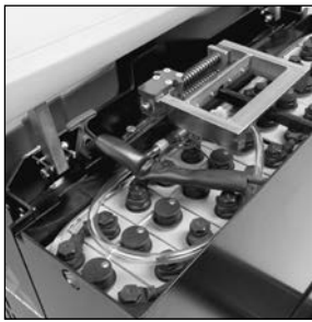
Baterías de gran capacidad
